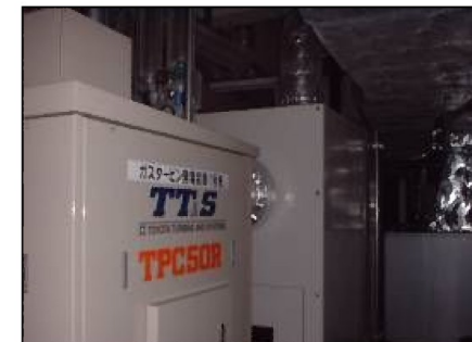
コージェネレーションシステム
