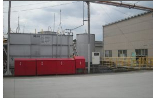
【水質】 屋外タンク・油水分離槽
