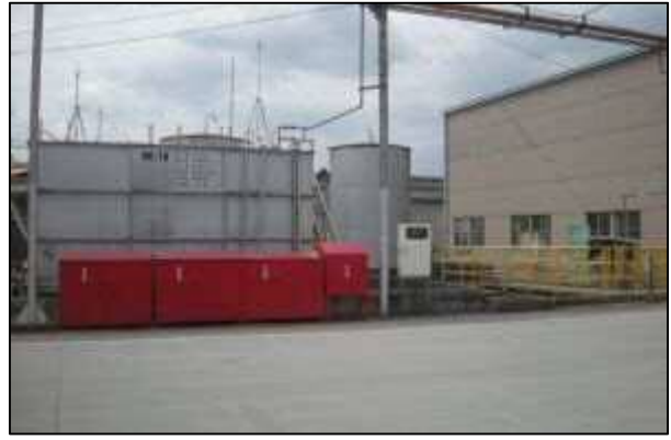
【水質】屋外タンク・油水分離槽
